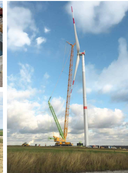
In der Nähe von Leipzig hat die NORD/LB 2017 einen Onshore-Windpark auf einem ehemaligen Tagebaugelände finanziert. 20 000 Haushalte können mit dem dort erzeugten Strom jährlich versorgt werden.
